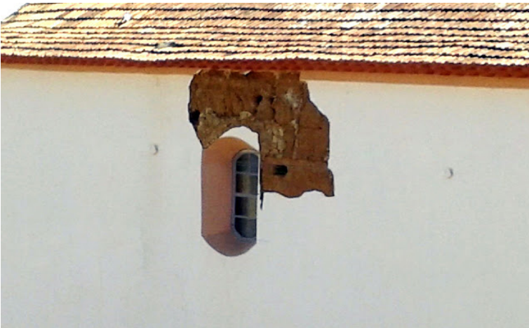
Foto 20: Em 2014 foi possível ver que suas paredes são de barro e trançadas com madeira e bambu após a queda de parte do reboco lateral.
